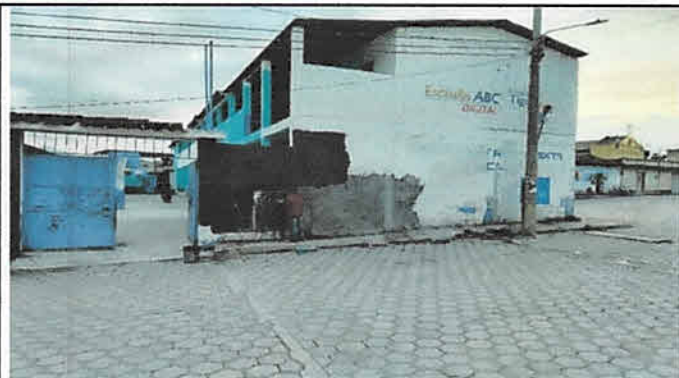
Foto 1: DETERIORO DE LA IMAGEN DE LA ESCUELA, COLOCAR REPELLO, Y PINTAR
