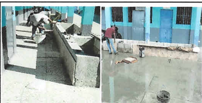
Foto 6: JARDINERA Y MESA DE ARENA A REPARAR
